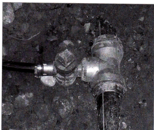
Branchement d'eau des particuliers au réseau
