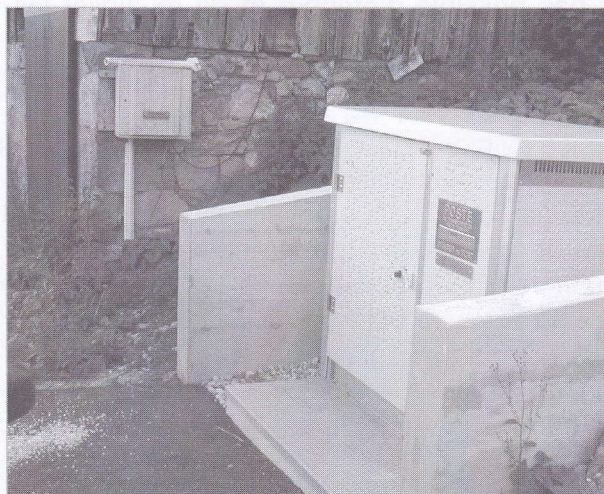
Photos emplacement transformateur «Romblaz»
